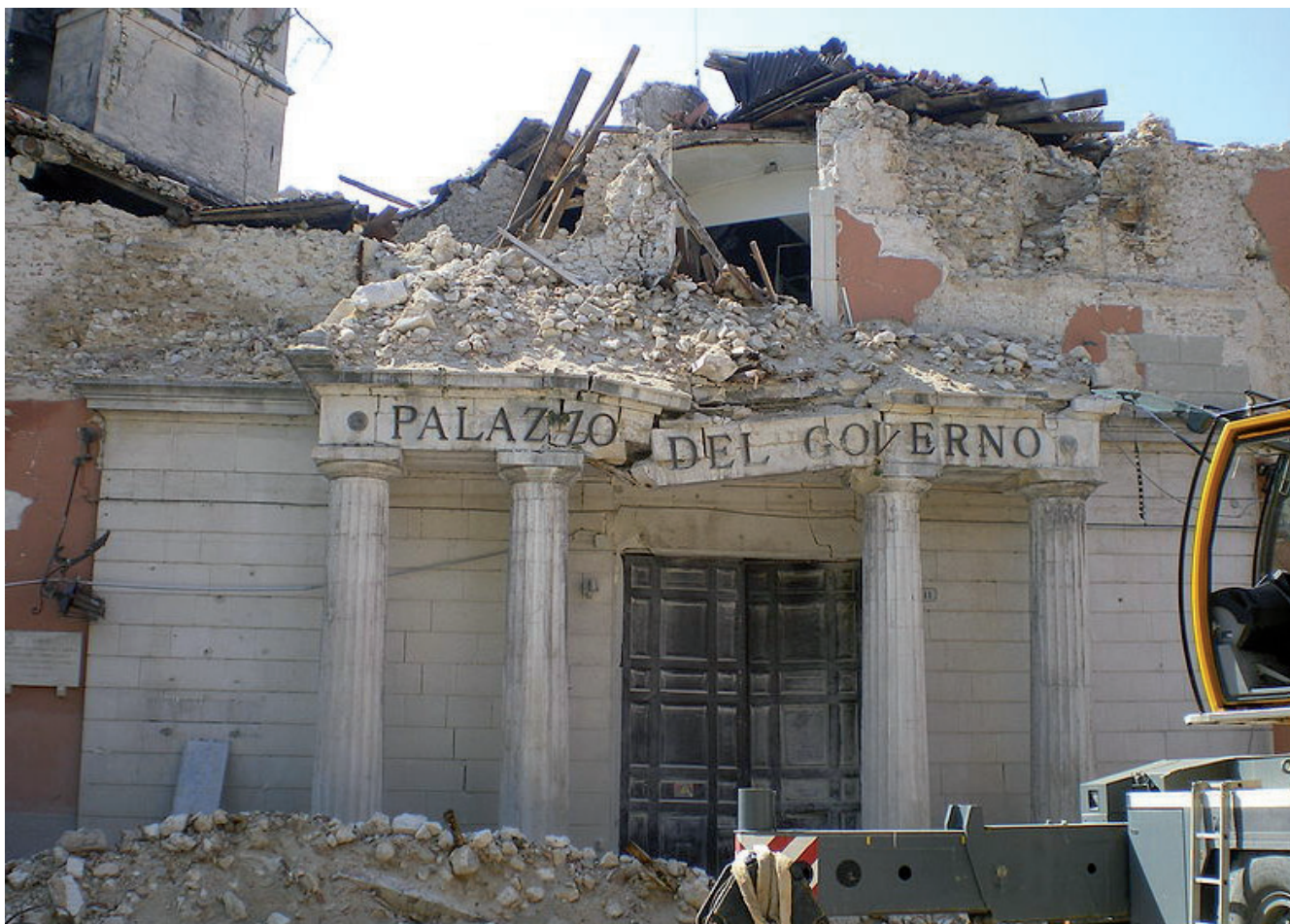
La sede della Prefettura di L'Aquila dopo il sisma.
